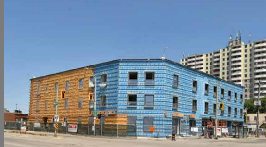
外壁のメンブレン防水層上に独立気泡の現場発泡断熱材 を施工、パッシブハウス要件を満たす性能を担保した
