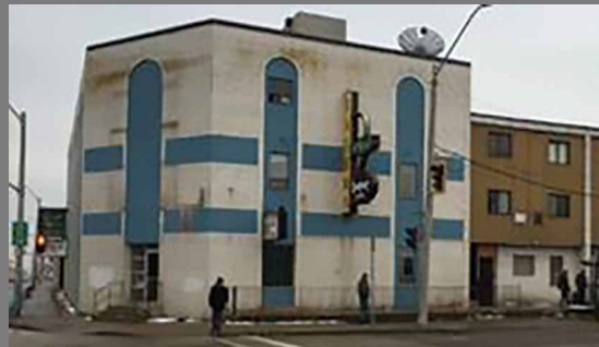
改修前：食堂、集会場、下宿からなる複合施設。 老朽化し、火害が残る放置建物
